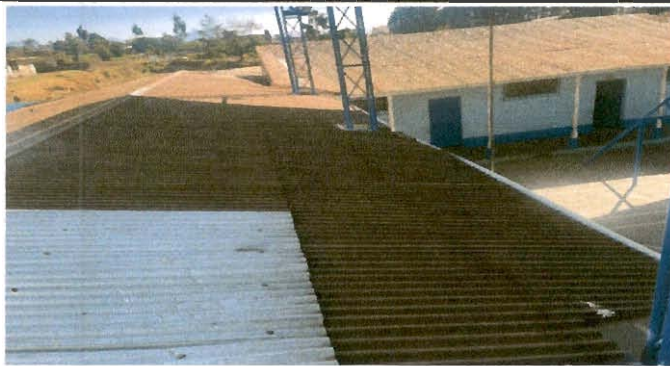
Foto1: CAMBIO DE LAMINA DE ZINC POR LAMINA TROQUELADA, EN MODULO UNO, DE TRES AULAS.
